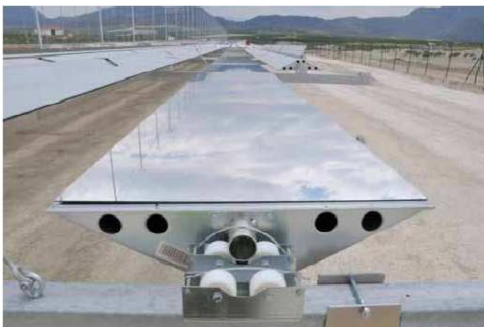
Figura 64: Reflector primario de la planta PE1
