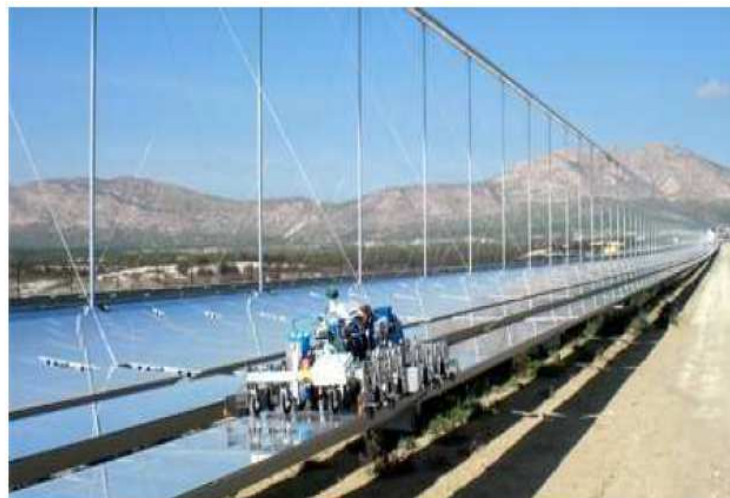
Figura 76: Limpieza automatizada de los espejos en la PE1
