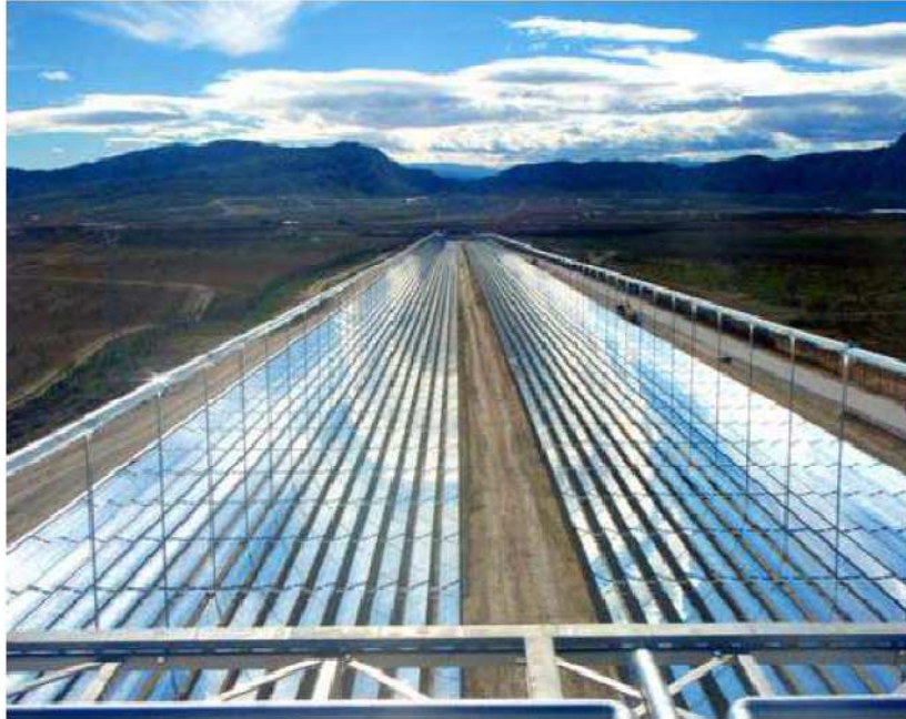
Figura 75: Fotografía del campo solar de la planta PE1
