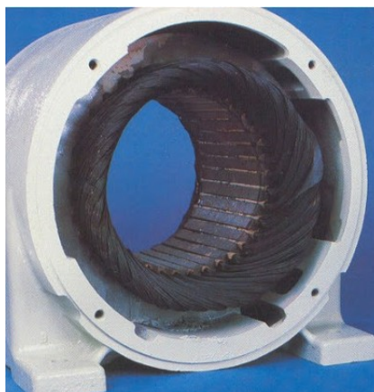
Figura 3.1 Bobinas del estator quemadas [5]
