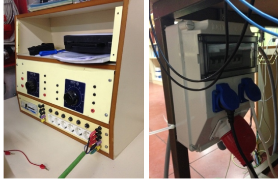
Figura 6.2 - Fuente de alimentación a la izquierda y caja de conexiones a la derecha
