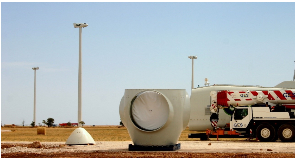
Figura 127. Instalación de aerogeneradores con torres de 105 metros de altura en el parque eólico San Lorenzo C. D. Herrero, 2010.
