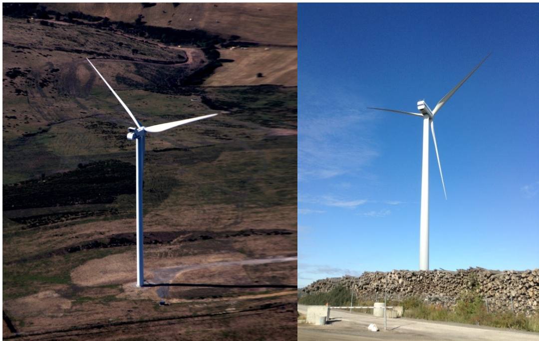
Figura 183. Aerogeneradores V112-3.0 MW.
