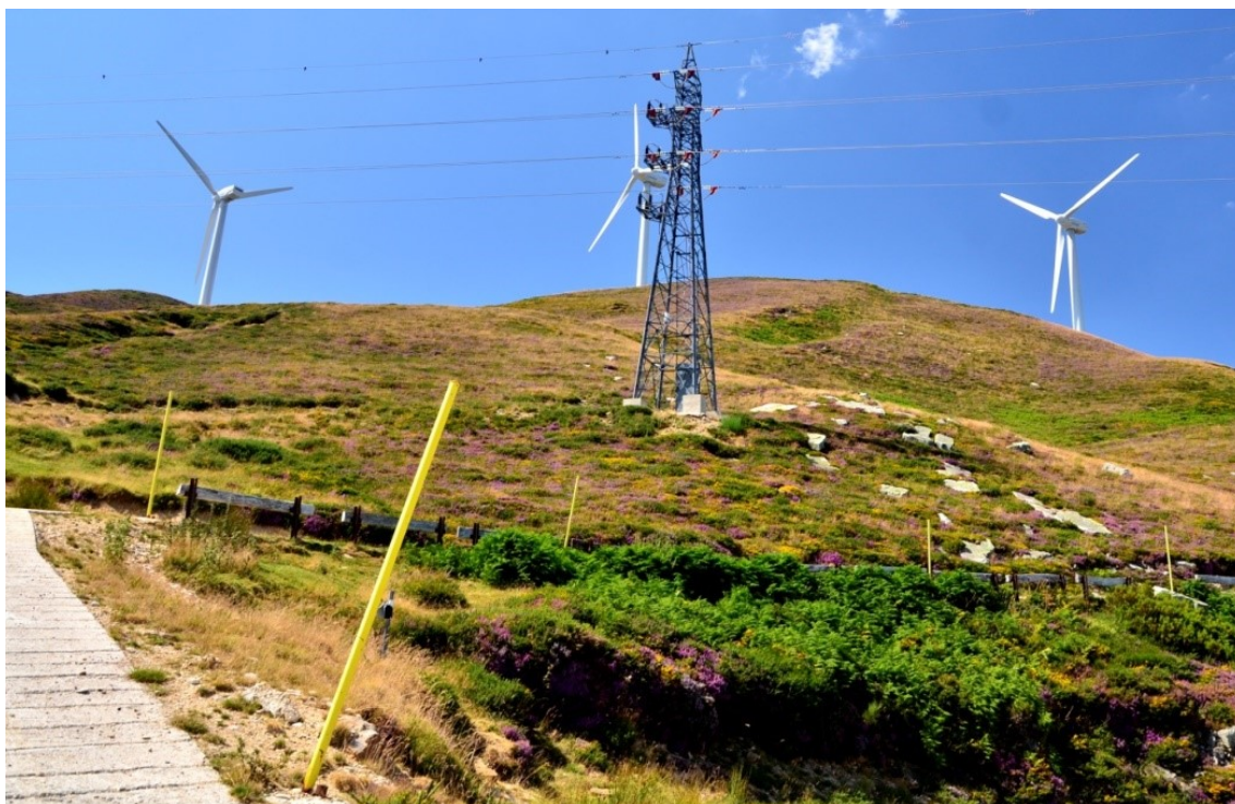
Figura 200. Viales y punto de conexión del parque eólico Los Castríos a la línea de evacuación a 66 kV. D. Herrero, 2012.
