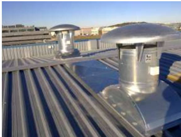
Imagen 28. Sistema de ventilación forzada
