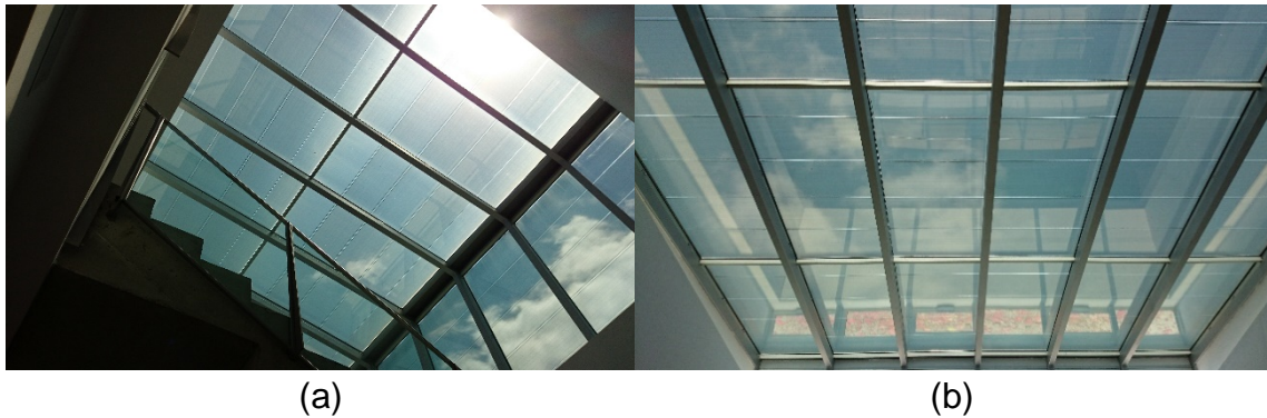
Figura 7.4. Sistemas solares fotovoltaicos instalados na cobertura do Edifício Lucia. (a) subsistemas 2 e 3 e (b) subsistema 4.
