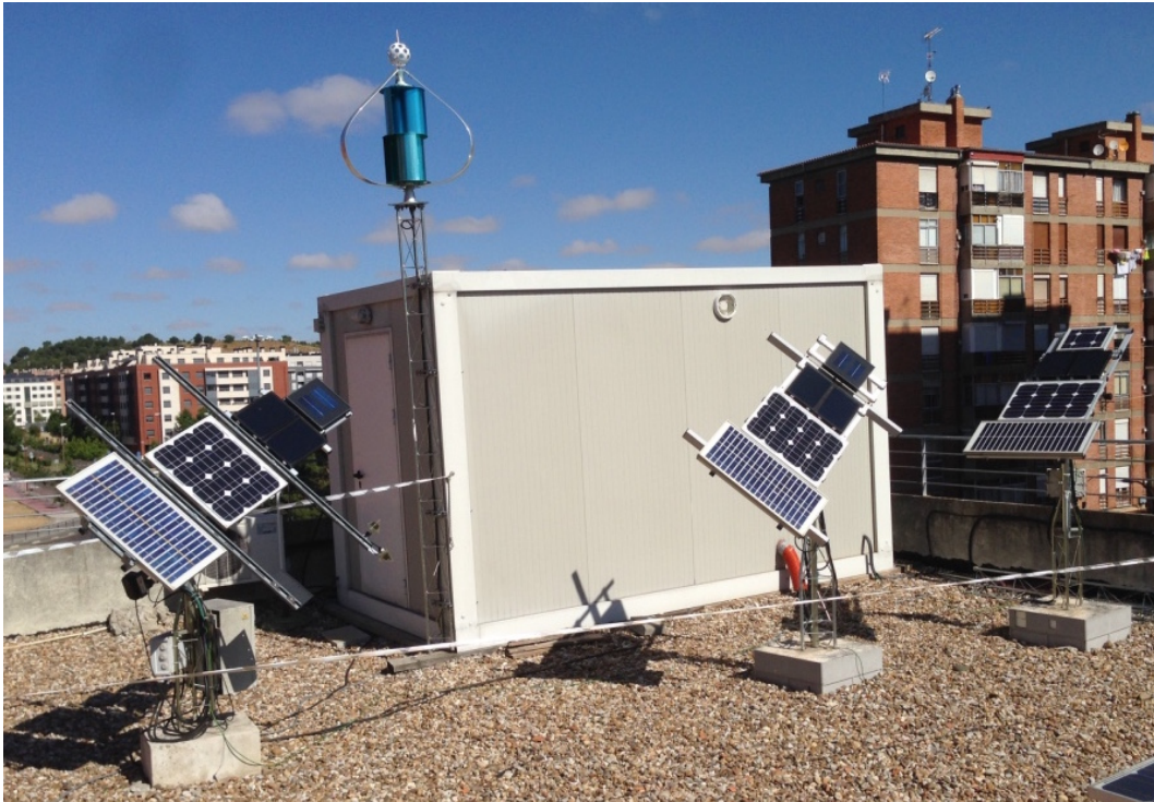
INSTALACIÓN FOTOVOLTAICA. LABORATORIO ENERGÍAS RENOVABLES EII
