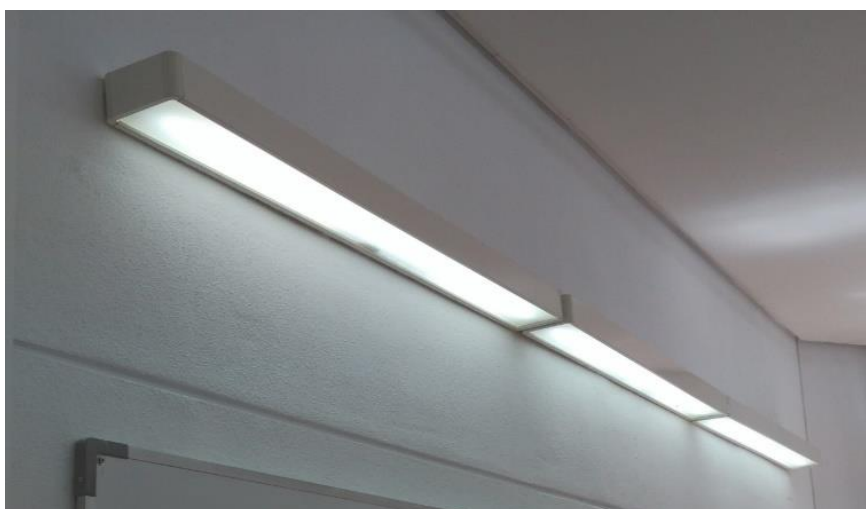
Figura 55. Luminarias con una lámpara fluorescente Lumilux T8 OSRAM 58W/840 en pared. Fuente: Elaboración propia
