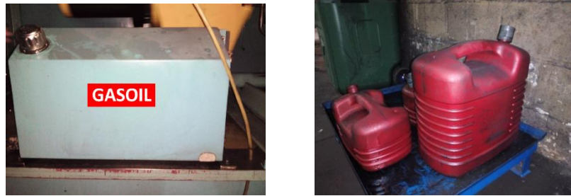
Fig 28: Señalización de depósito
