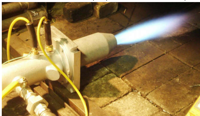
Figura 6.2 Quemador EQA para crisol de zinc fundido.
