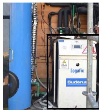
Imagen12. Ubicación de la bomba de calor en la Casa Solar.
