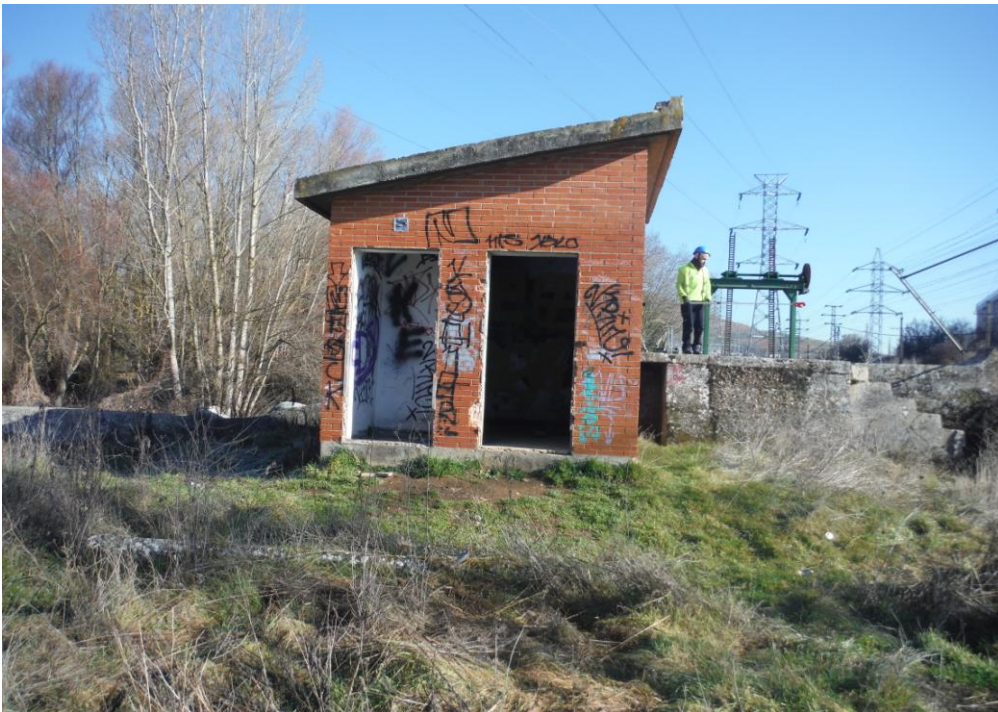
Ilustración 10: Detalle caseta abandonada del margen izquierdo
