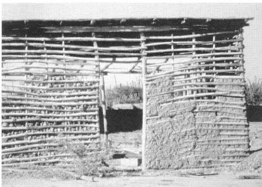
Figura 100: Deterioro del bahareque debido al mal recubrimiento y a la aparición de fisuras.
