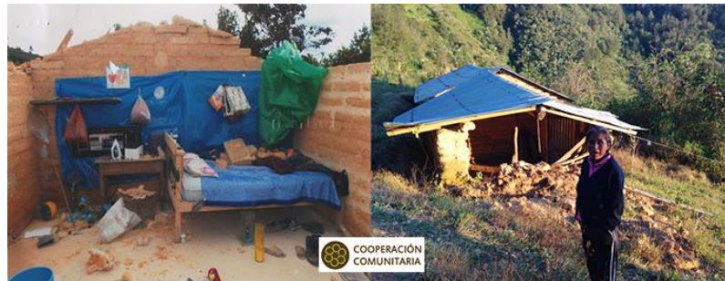
Figura 152: Estado de las viviendas después de las intensas lluvias.
