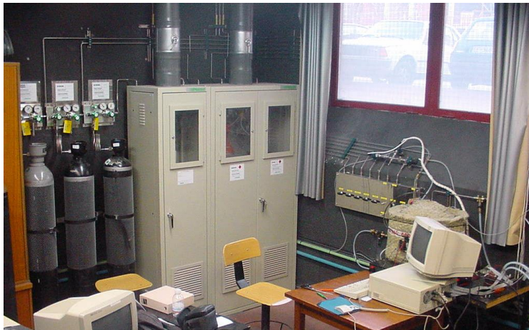
Figura 4. Vista general de la instalación donde se muestra la zona de almacenamiento de gases, panel de control de suministro, bomba de combustión, y computador de control del sistema [Lafuente, 2008].
