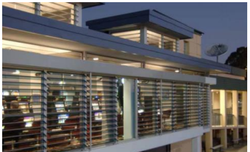
Celosías móviles. Fuente: lumenhaus.es
