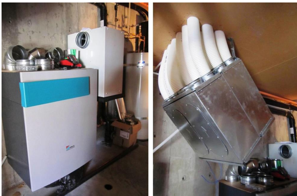
Sistema de ventilación en cadena. Fuente: 1.bo.blogspot.com
