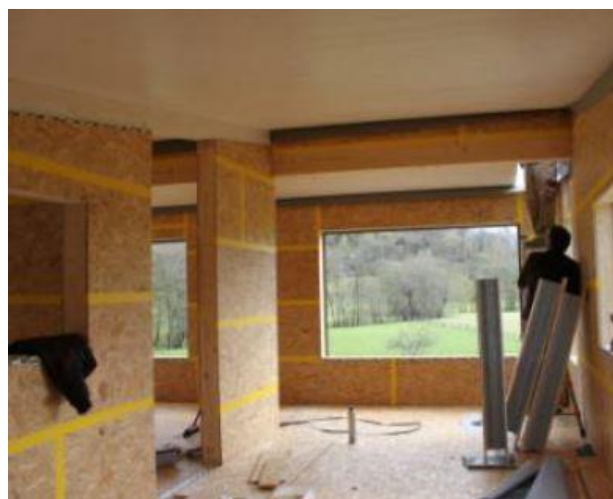
Juntas selladas en tableros OSB. Fuente: duqueyamora.com
