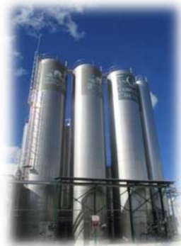
Fig. Nº 4. Tanques isotermos de almacenamiento
