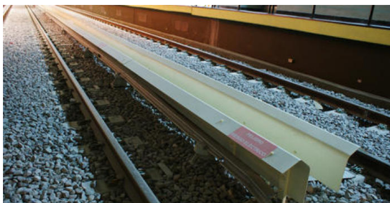
Fig. 2.2.1 Tercer riel en una estación
