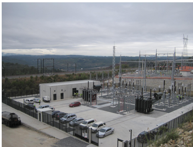
Fig. 2.1.2 Subestación Tracción Orense – Santiago
