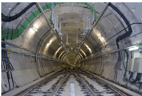
Fig. 2.2.7 Catenaria rígida metro Madrid
