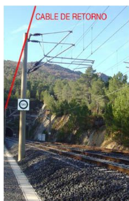
Fig. 2.4.2 Cable de retorno catenaria CA
