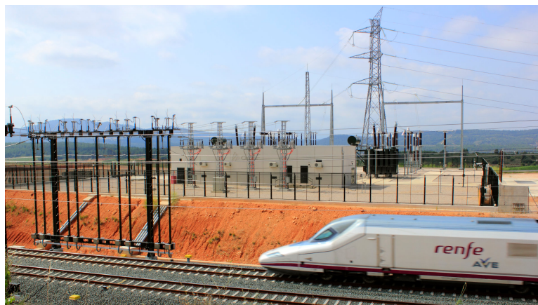
Fig. 2.1.1 Subestación Tracción AVE
