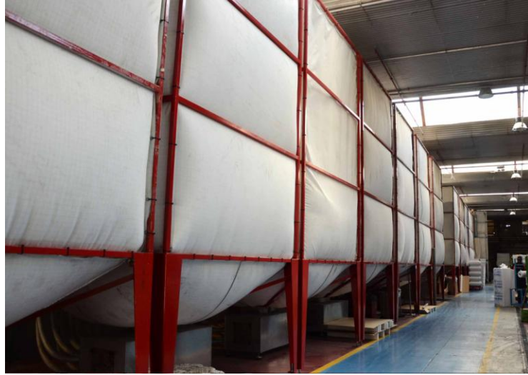
Img. 31: Silos de reposo
