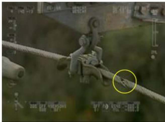
Figura 52, daño en cable guarda.
