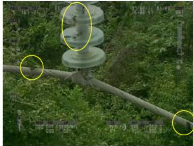
Figura 53, daños por descarga eléctrica en cable conductor y aislamiento.
