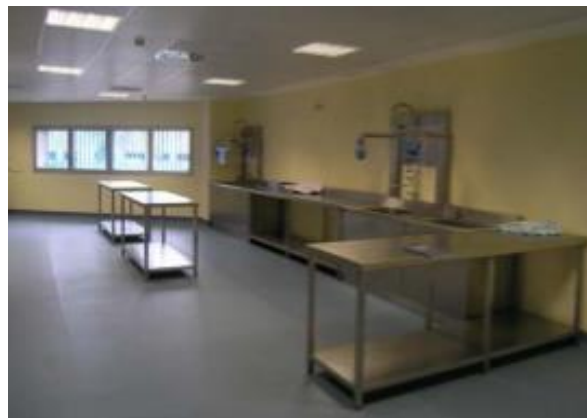
Figura 3.7. Zona de lavado manual con dos estaciones ergonómicas de lavado y ultrasonidos, con pantalla antisalpicaduras y pistolas suspendidas de aire-agua. (Ministerio de Sanidad, Política social e igualdad, 2011).
