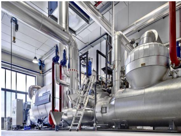
Ilustración 43, instalación turbogeneradora Turboden
