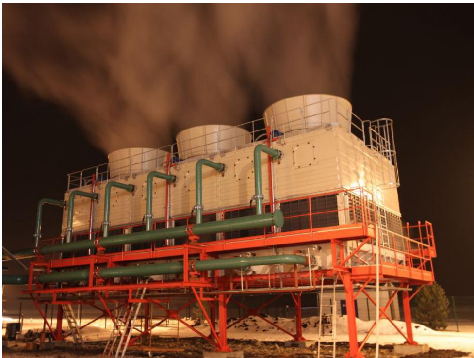
Ilustración 45, batería de 3 torres de refrigeración TEVA
