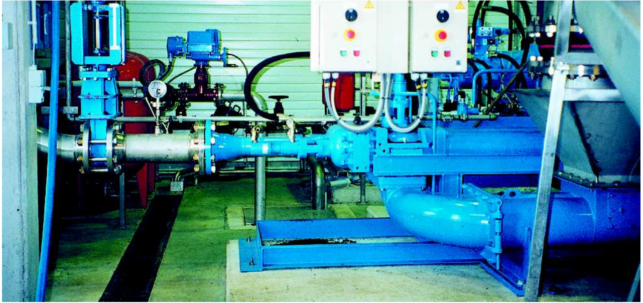
Aplicación típica de una bomba SH de ABEL: transporte de lodos de depuradora deshidratados en una planta de tratamiento de aguas residuales en Bélgica.
