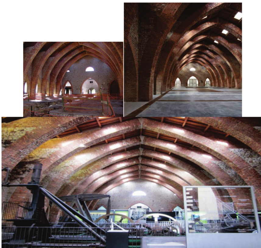
Figura 5: Fases de la rehabilitación de la lonja de forja y laminación de la ferrería de San Blas (de izd. a dcha. 2001, 2007 y abajo 2014)
