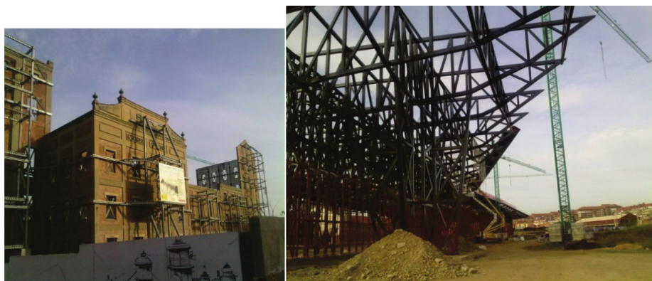
Figura 8: Obras de rehabilitación de la «Santa Elvira» para usos de Palacio de Congresos y Exposiciones en León
