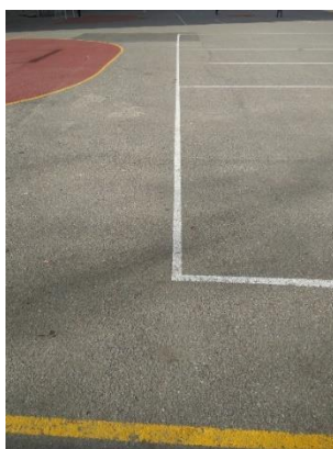
Figura 15. Mal estado de las instalaciones prestadas
