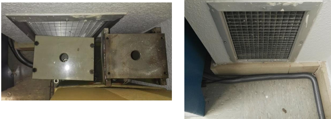
Figura 5.10: Rejilla extracción de aire en sala Mecánica-Fuerza y Par antes y después.
