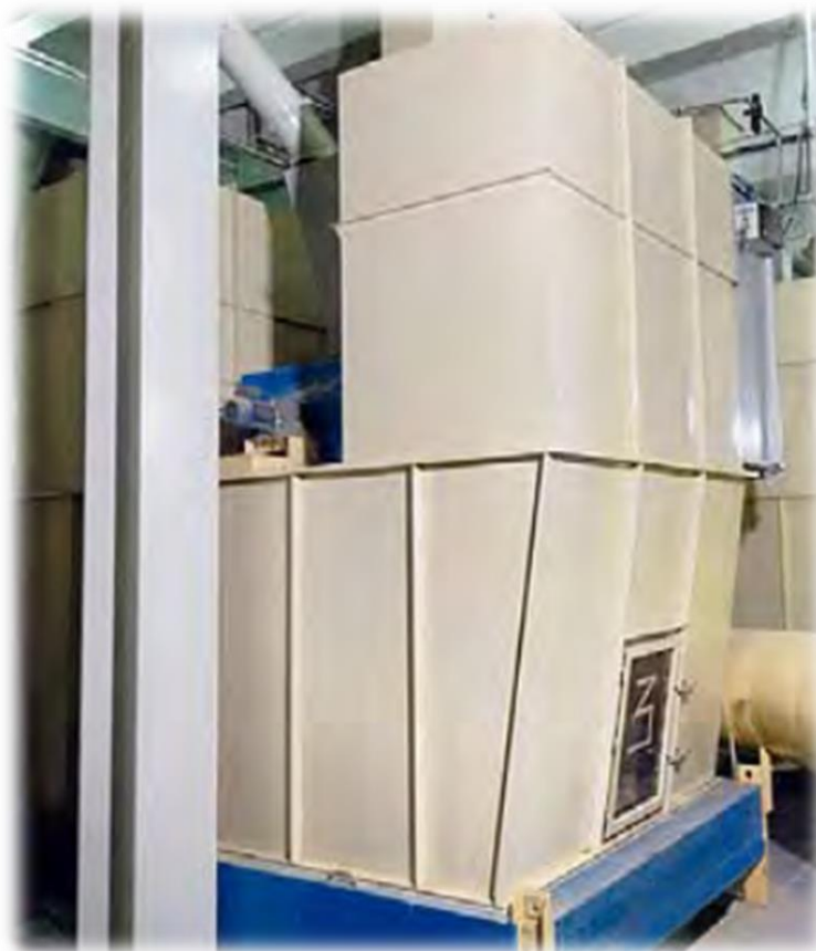
Ilustración 21: Enfriador de aire forzado vertical
