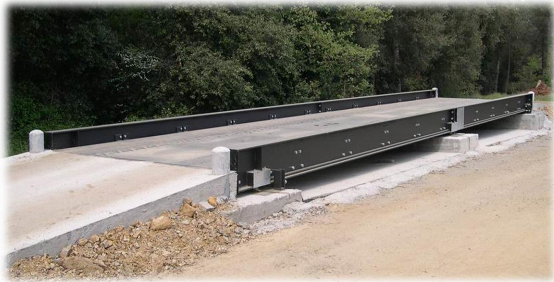
Ilustración 16: Báscula de pesaje elevada con protectores de seguridad
