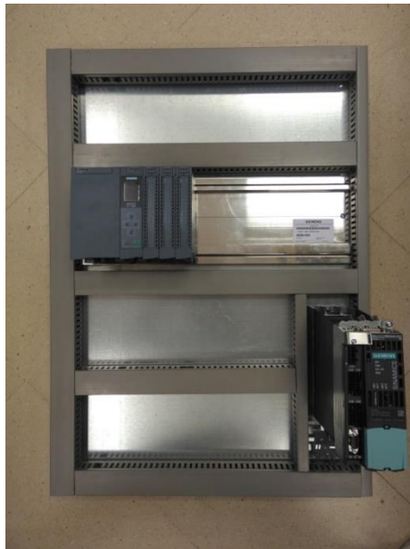
Figura 19: Montaje de PLC s7-1512.
