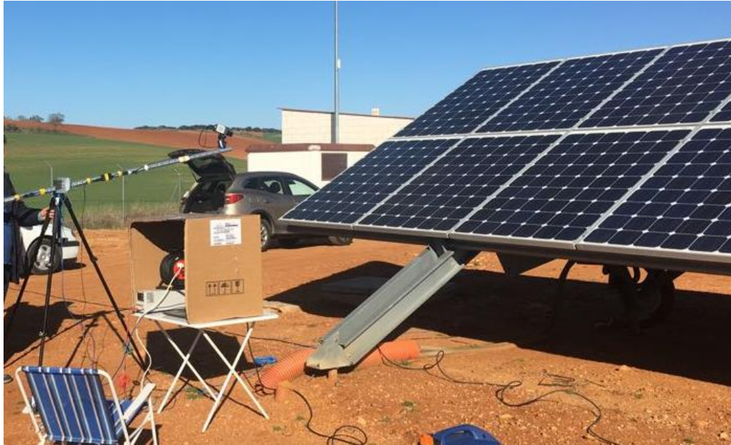
Imagen 42. Proceso de medida de EL en planta fotovoltaica mediante el primer prototipo
