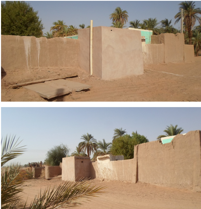
Figura 3a/3b. Sanitario seco construido en el exterior del recinto cercado de la vivienda, Soleb (Sudán). En la figura de arriba puede observarse el conducto de ventilación de la cámara de descarga y la tapa, aún sin rematar, para la recuperación de las heces. Fuente: F. Jové.
