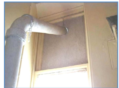
Ilustración 7. Conducto de evacuación de humos de fibrocemento
