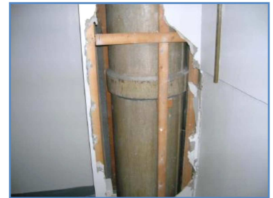
Ilustración 5. Caja de tablero aislante parcialmente retirada
