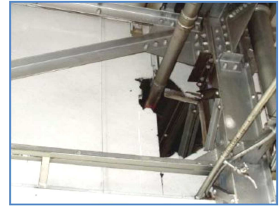
Ilustración 6. Tabique de separación de tablero aislante de amianto
