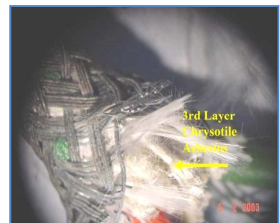
Ilustración 8. Cables aislados con amianto
