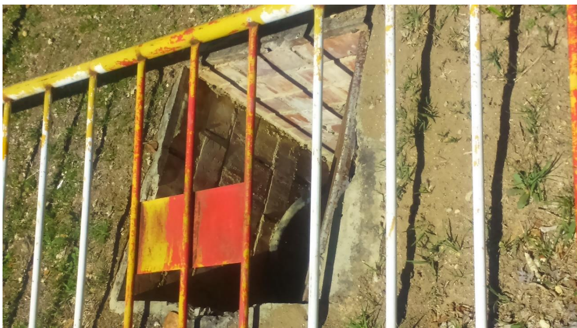
Figura 29. Tapa de arqueta en mal estado presente en zona 2_d.
