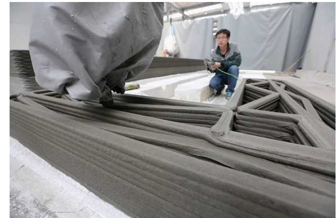
Impresión 3d a gran formato de un módulo habitacional mediante la impresora 3d de la empresa "Winsun New Materials"
