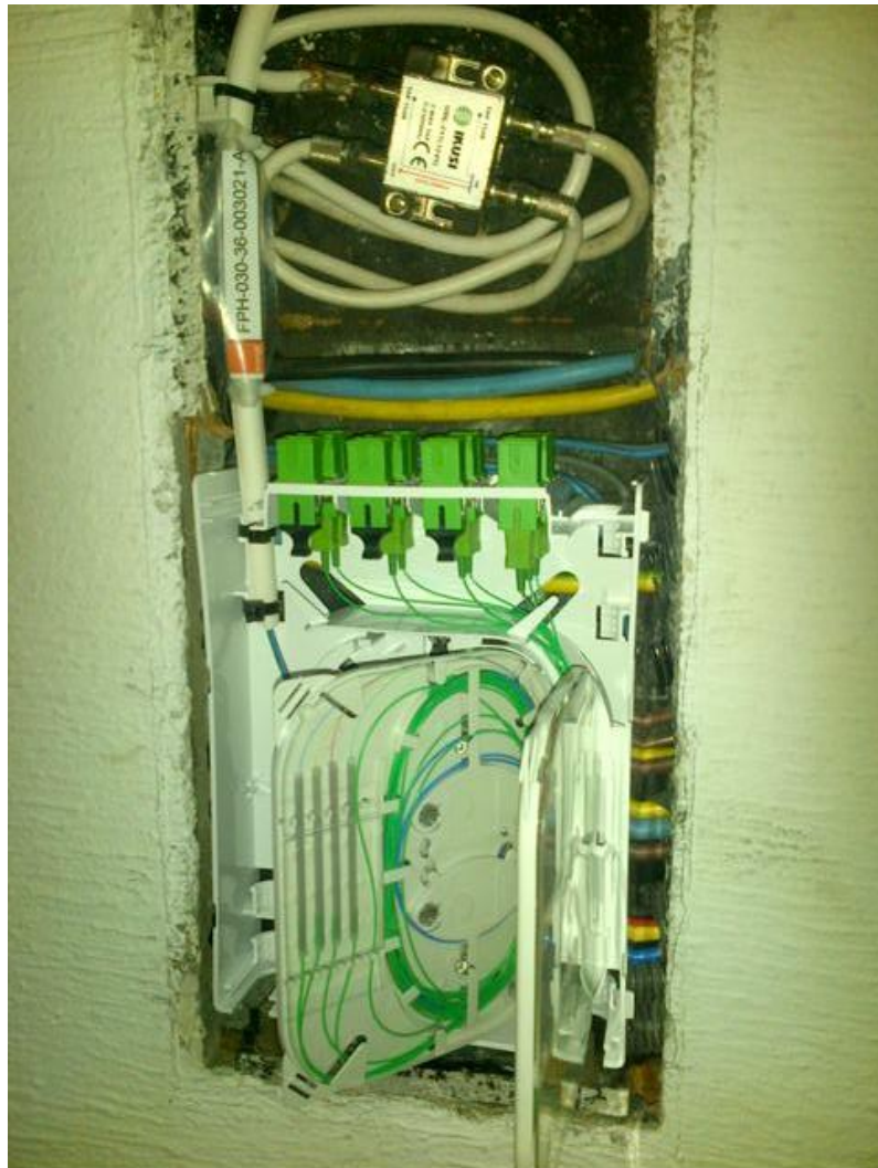
Figura 6. Caja de derivación de planta
