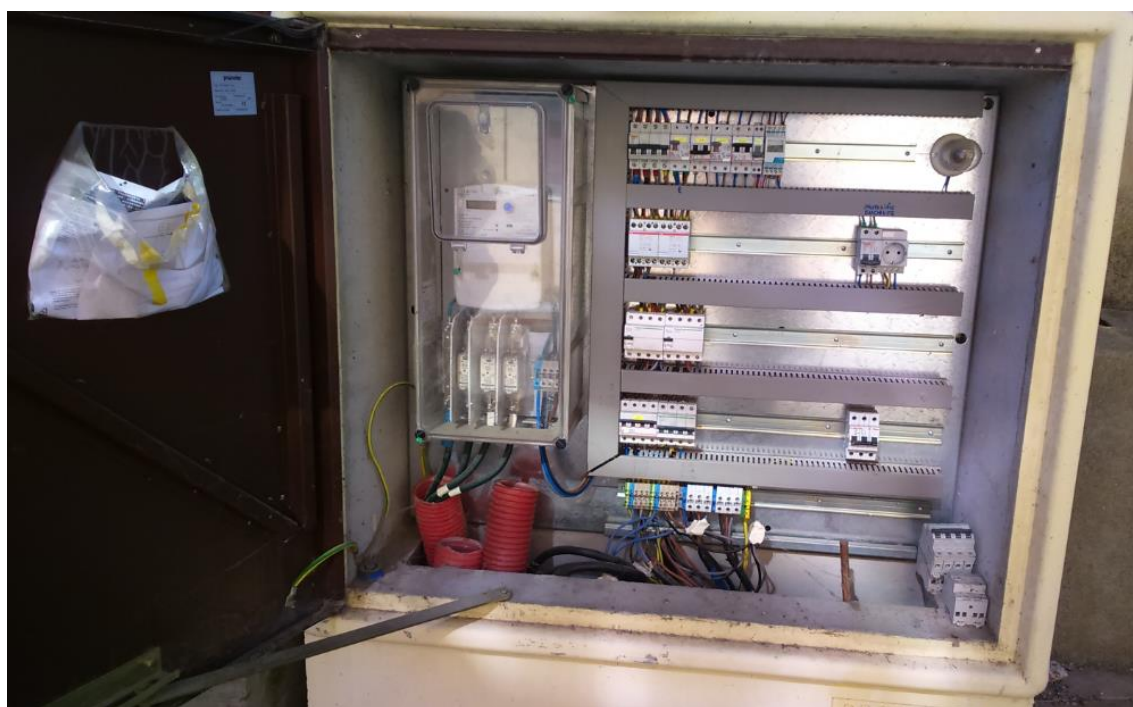
Figura 41. Cuadro eléctrico de alumbrado de Cabezón de Pisuerga. Fuente: Elaboración propia.
