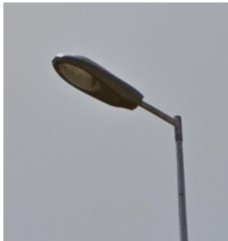
Figura 17. Luminaria FAROLA VIAL. Fuente: Elaboración propia
