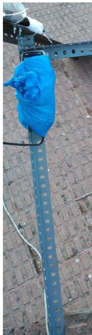
Figura III.3.2. 10 Situación medidores multifunción.
