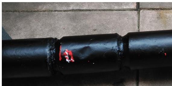
Figura IV.2.1. 13 Pintura resquebrajada en el conducto de latas.
