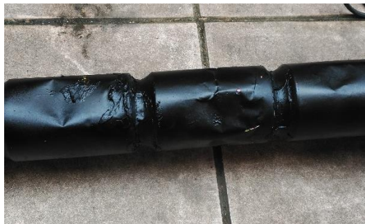
Figura IV.2.1. 12 Pequeños golpes y abolladuras en el conducto de latas.
