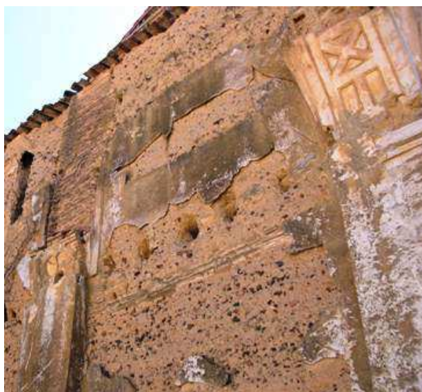
Restos de los pilares y arranques de los arcos fajones del templo.
