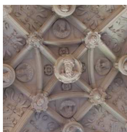
Bóvedas de la Catedral de León (izquierda) y bóvedas del claustro de San Zoilo (derecha).
