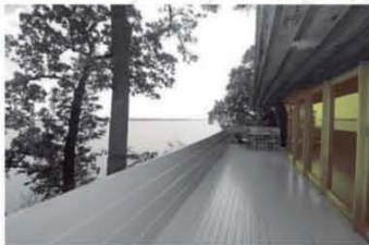
Las terrazas forma voladizos hacia el Lago para poder apreciar las vistas.
