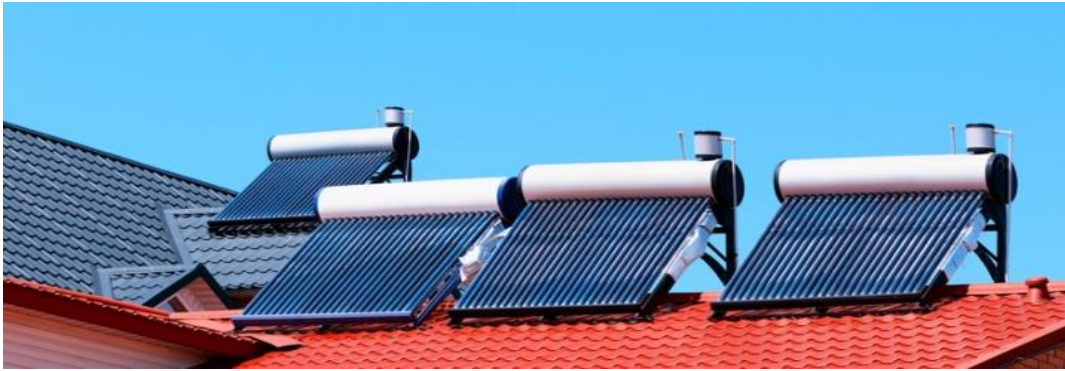
Figura 11: Paneles solares térmicos
