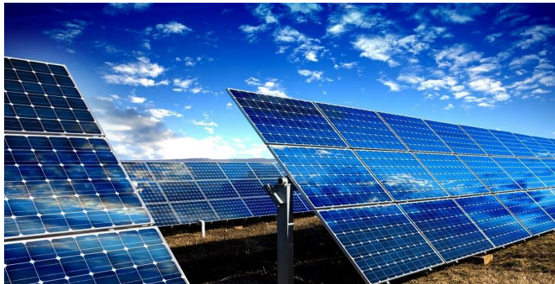
Figura 6: Paneles solares fotovoltaicos
