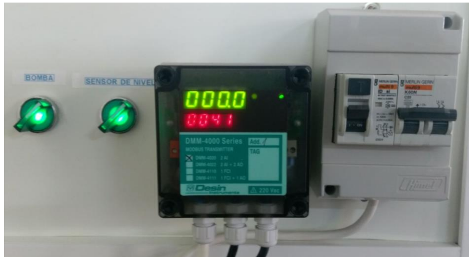
Figura 5.13. Accionamientos eléctricos y medidor de la planta.
