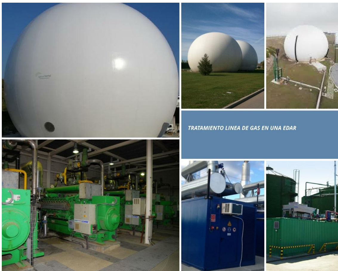
Figura 8. Tratamiento línea de gas. Elaboración propia. Fotos EDAR Valladolid.
