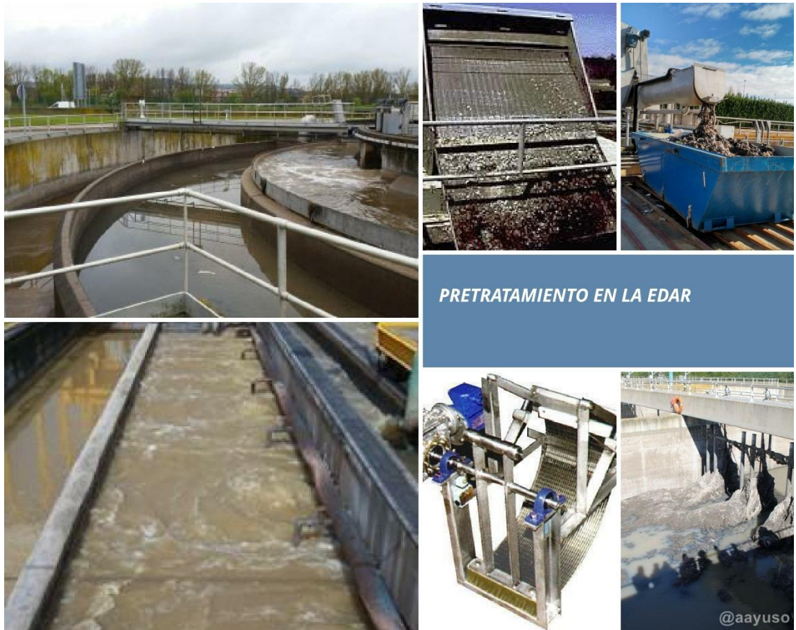
Figura 1. Pretratamiento línea de agua. Elaboración propia. Fotos EDAR Valladolid.
