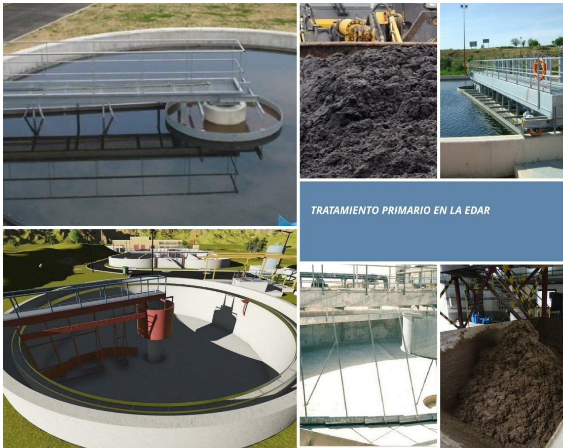
Figura 2. Tratamiento primario línea de agua. Elaboración propia. Fotos EDAR Valladolid.
