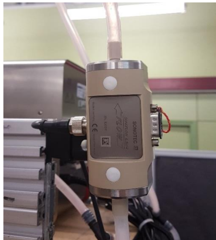
Figura. 3.17 Caudalímetro y colocación en la instalación
