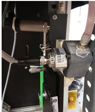
Figura. 3.18 Sensores de presión en la instalación
