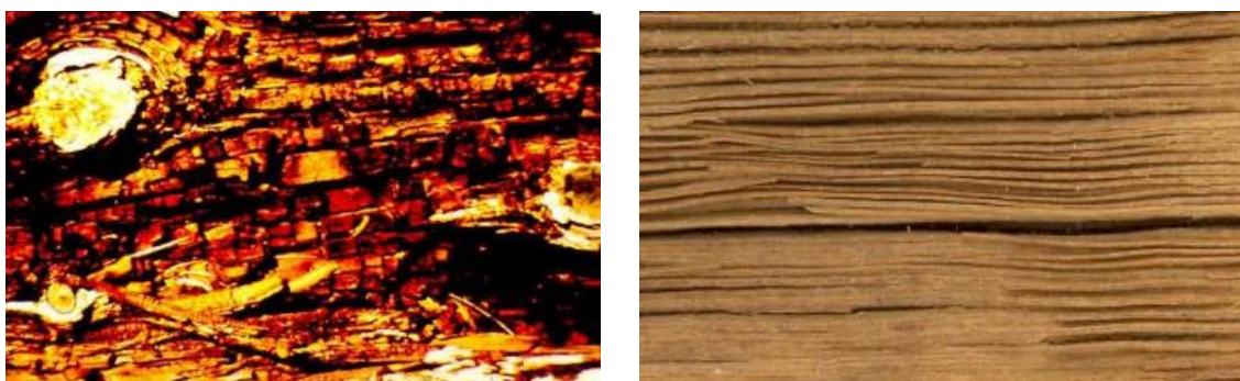
Figura 2. Madera atacada por hongos de pudrición parda o cúbica (izquierda) y madera atacada por hongos de pudrición blanca (derecha). Fuente: Vignote & Rojas (2016).
