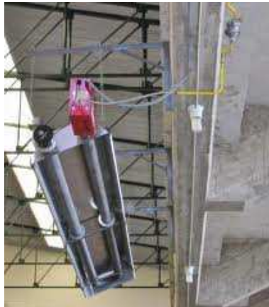
Figura 17.5. Tubo radiante inclinado
