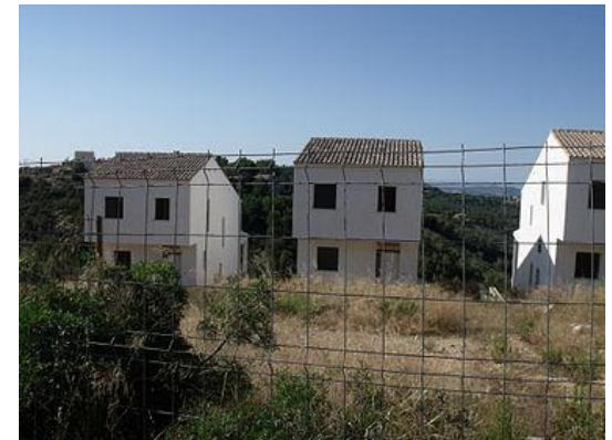
Fig. 31 Viviendas de segunda residencia inacabadas, cerca de Valencia. Muchos proyectos se abandonaron ante la imposibilidad de financiarlos o venderlos/Fuente: https://es.wikipedia.org/wiki/Crisis_inmobiliaria_española_de_2008-2014
