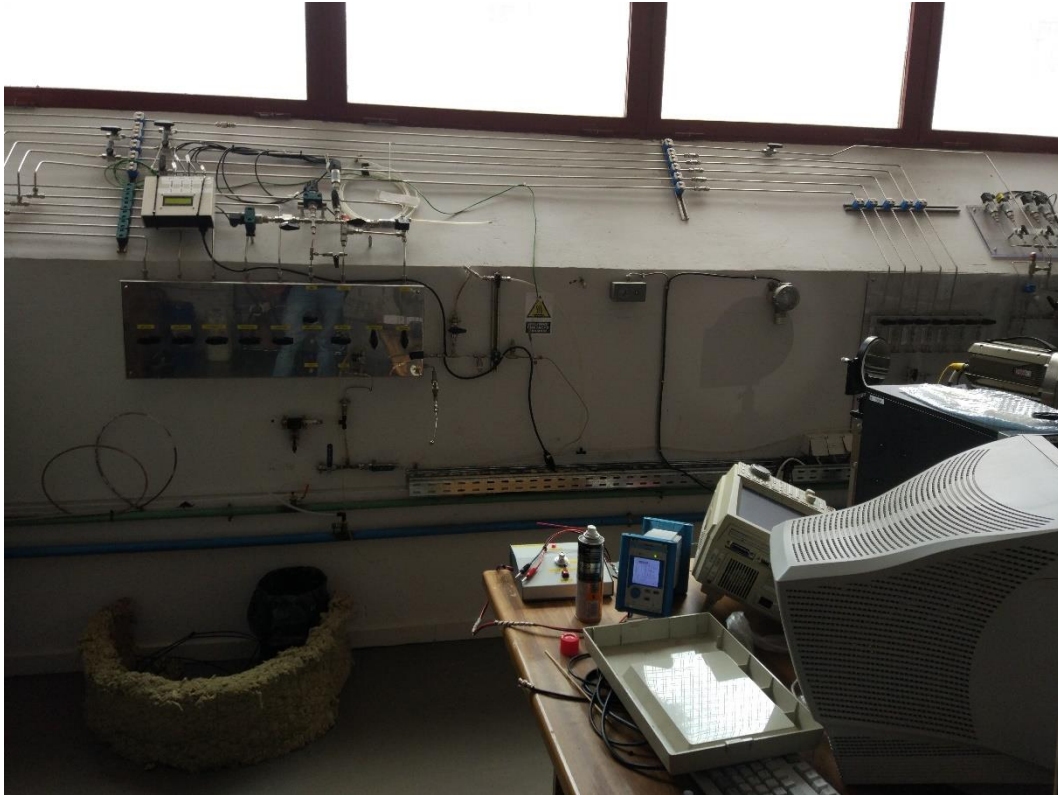
Fig. 1.2.1. Laboratorio de Motores Térmicos de la Universidad de Valladolid (Elaboración propia)
