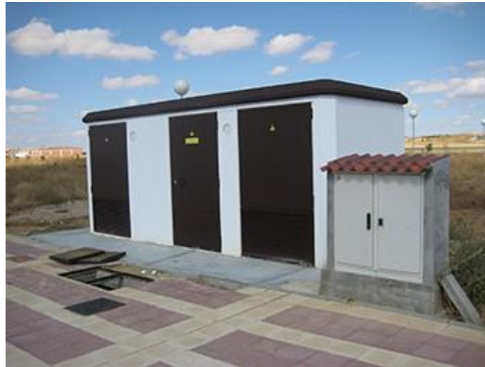
ILUSTRACIÓN 32: CENTRO DE TRANSFORMACIÓN
