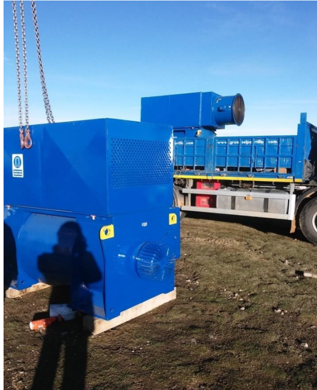
Figura 37: Generador roto en el camión y nuevo en el suelo. Elaboración propia.
