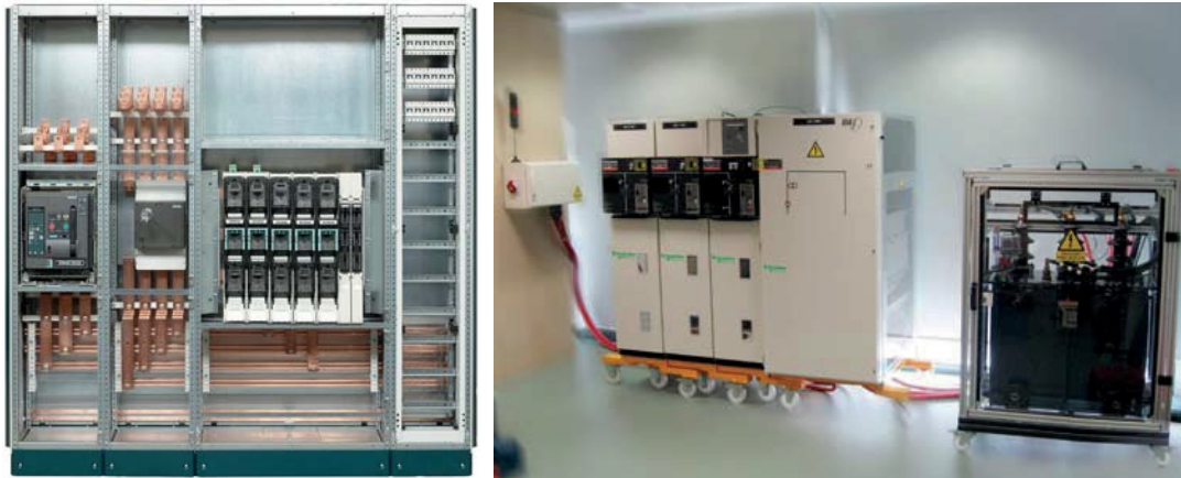
Caja General de Protección mediante Barras Tripolares Verticales / Equipo Transformador.
