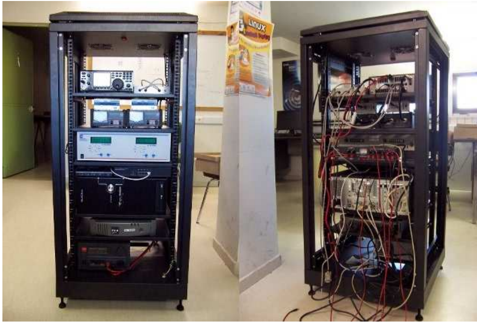
Figura 11. Rack con los equipos de la estación terrena
