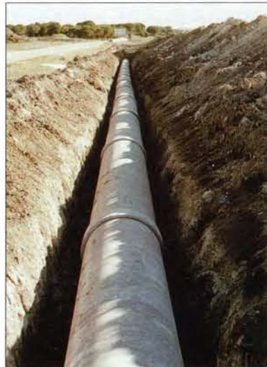
11. Canalización para el riego, realizada sin autorización en 1999. Obsérvese al fondo de la misma la espalda de uno de los carteles de señalización de la Zona Arqueológica.
